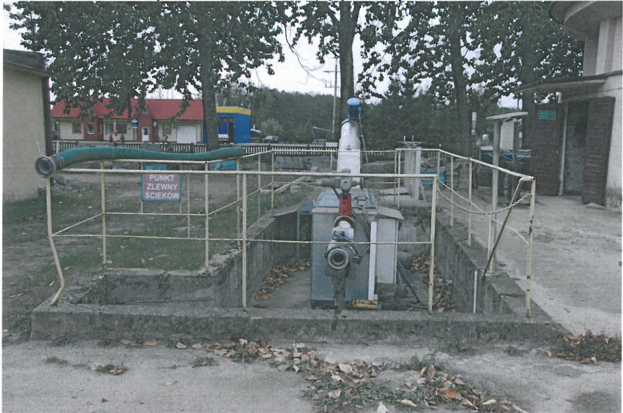
Rys.1. OB.-1A Stacja zlewna ścieków
